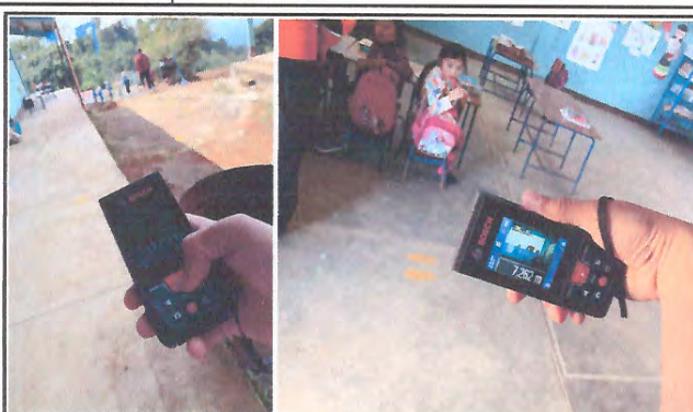
Foto 2: Vista de Modulo 1 de Aulas, que requiere mejoramiento de piso en Aulas + Pasillo
