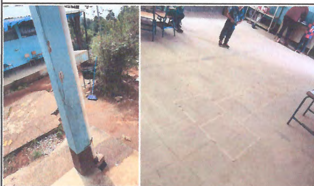
Foto 4: En el Modulo 2 de aulas, necesitan reparar 1 columna de pasillo y realizar mejoramiento de piso en aulas + pasillo.
